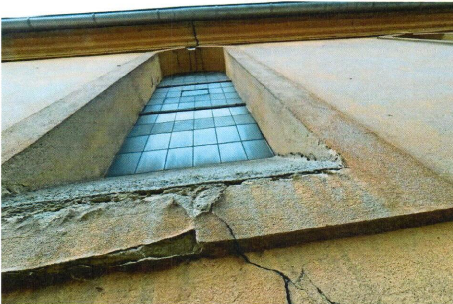
Eine fehlerhafte Dachkonstruktion aus der Bauzeit der Kirche ist Schuld an den Rissen im Mauerwerk. Quelle: Uwe Klemens
